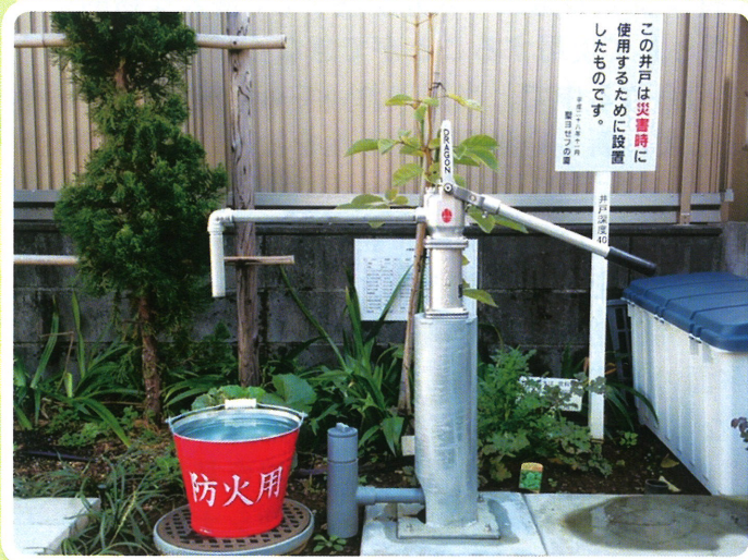
地下40mより深い層を流れる地下水を汲み上げる構造になっています。 この井戸水は、静岡県生活科学検査センターによる水質検査の結果、飲料水の水質基準に適合しています。
